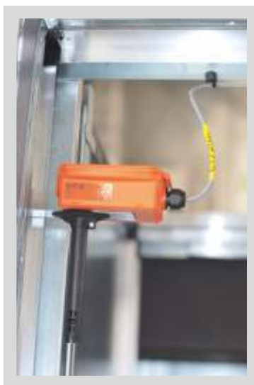
Zamontowane elementy wykonawcze i pomiarowe automatyki
